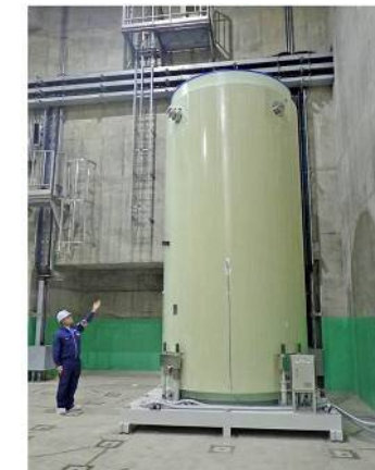
むつ市の使用済燃料中間貯蔵施設に保管されているキャスク 2024.12.4 東奥日報
